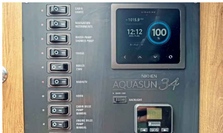
Wszystkie instalacje elektryczne wykonane są solidnie.
